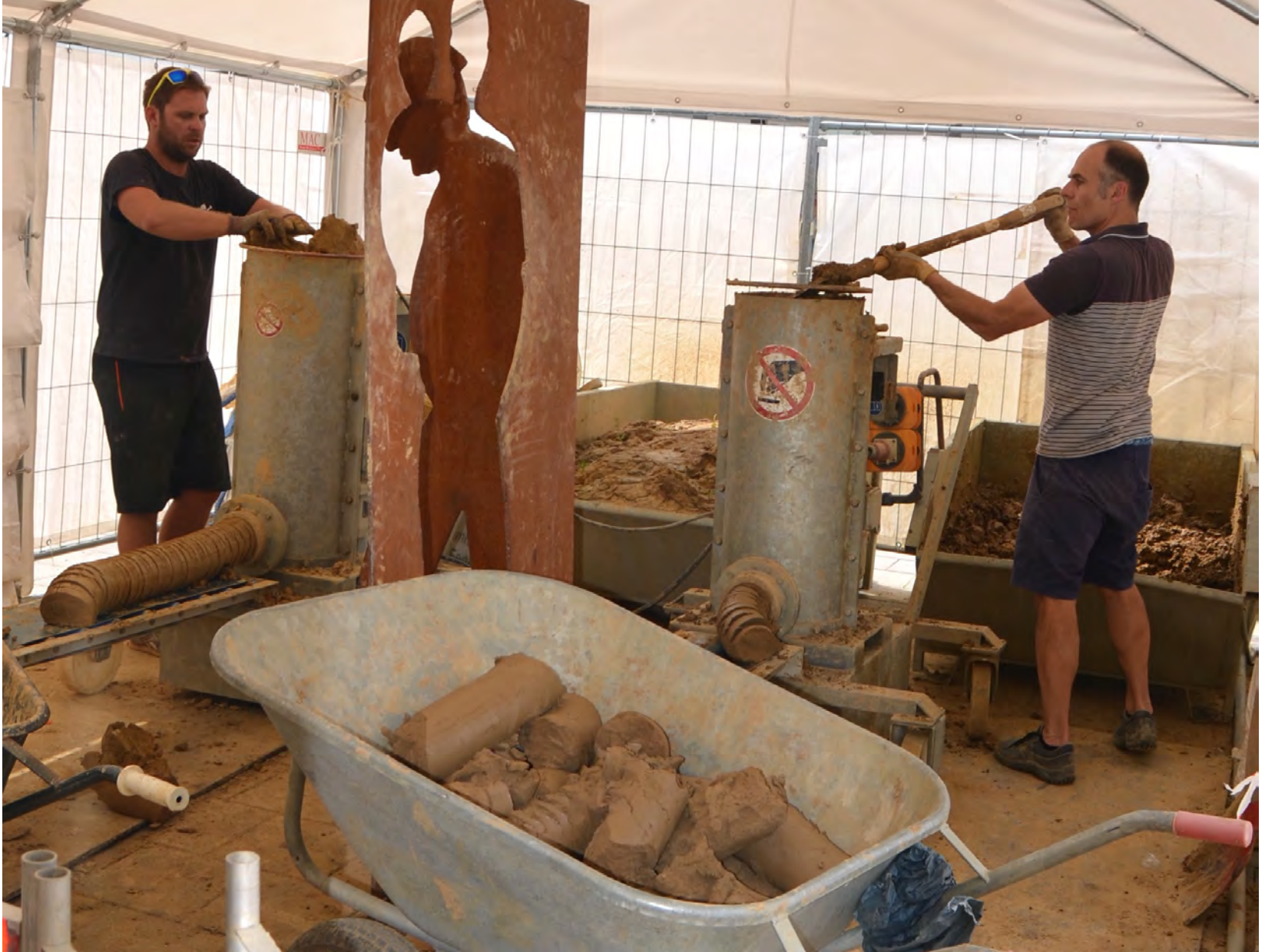
Mit der selbst konstruierten Maschinen produzieren die Kollegen leicht handhabbare Lehmstränge. Ca. 70 Tonnen Lehm werden verbaut.
